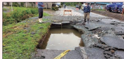
西部用水路破損の状況
