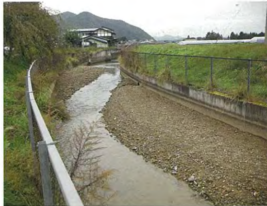
写真② 鹿妻本堰（盛岡市上鹿妻地内） 氾濫した猪去大沢から流入した土砂
