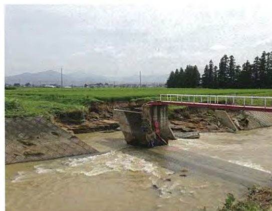
写真⑥ こうすいじせきあげ 太田川 高水寺堰上ゲート（矢巾町北郡山地内） ゲート左岸側の決壊
