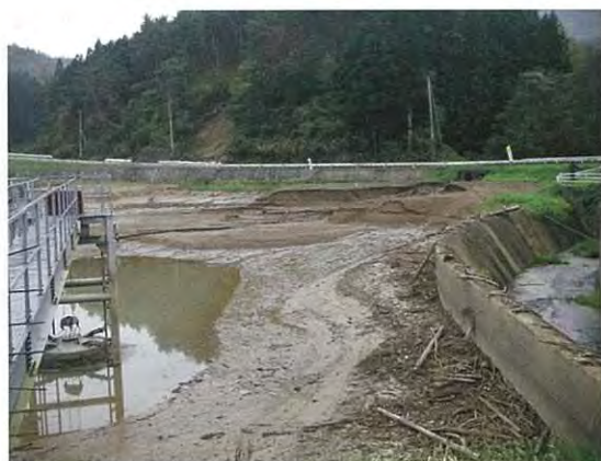
写真⑤ 田沢ため池（矢巾町和味地内） 山から流入した土砂
