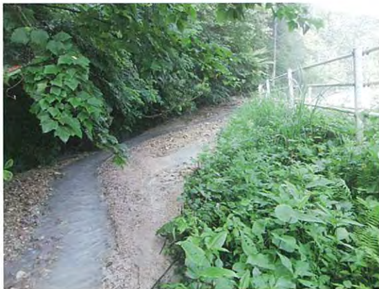
写真① だいがけき 大欠堰（盛岡市繋地内） 沢から流入した土砂
