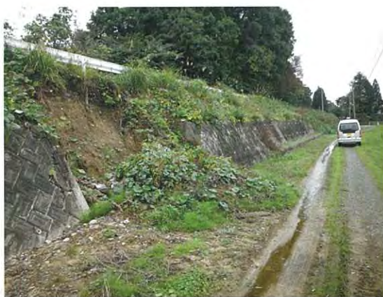
写真③ 幹線用水路（盛岡市羽場地内） のり面の崩落
