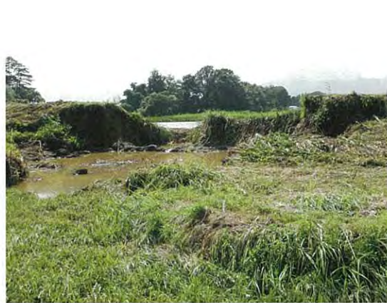
写真④ かみきんべいづみ 上金平堤（矢巾町広宮沢地内） 決壊した堤体
