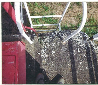
躯体破損状況
