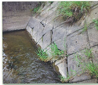
張ブロック破損状況
